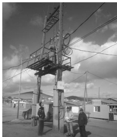
Рис. 1. Общий вид трансформаторной подстанции, на которой производились исследования
