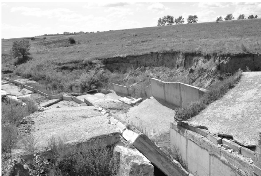
Рис. 5. Разрушенный ступенчатый береговой водосброс пруда № 10
