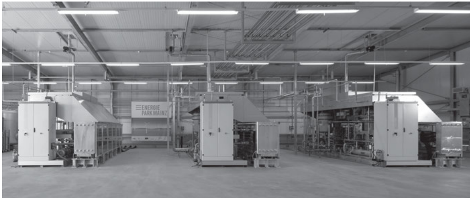
Figure 7.22: Electrolysers (Energiepark Mainz).
