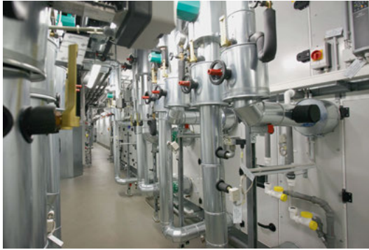
Abb. 13.42: Raumluftechnische Anlage der Sonderisolierstation (SIS) Düsseldorf.
