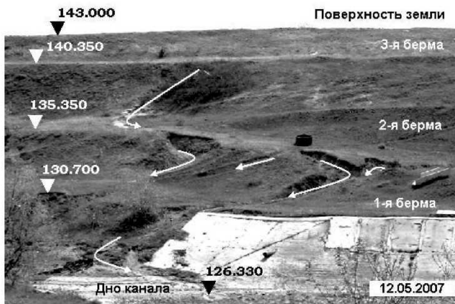
Рис. 5. Серповидные эрозионные формы на левом склоне канала перед насосной станцией № 2, первый бьеф
