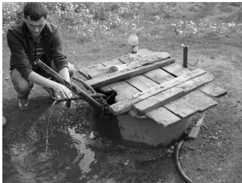
Рис. 3. Водоразборный узел на сети в с. Приозерное
