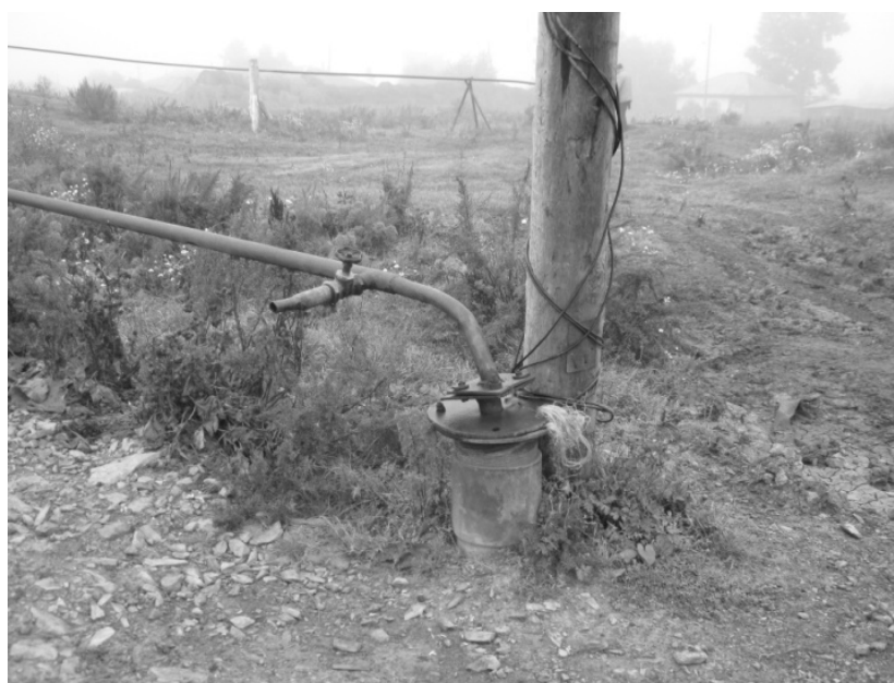
Рис. 2. Оголовок эксплуатационной скважины на водозаборе с. Кабаново
