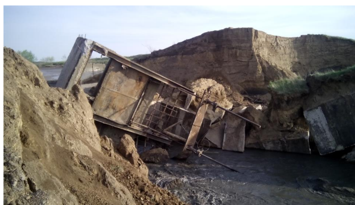
Рисунок 2. Разрушение водопропускного сооружения и образование прорана
